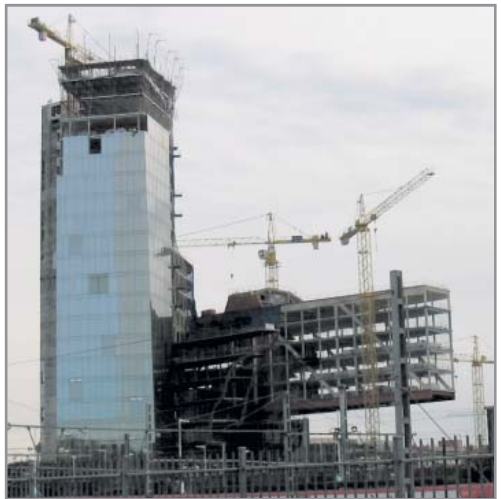
IMAGEN DE LAS OBRAS EN LA TORRE MARE NOSTRUM DE ENRIC MIRALLES Y SU MUJER, BENEDETTA TAGLIABUE.
